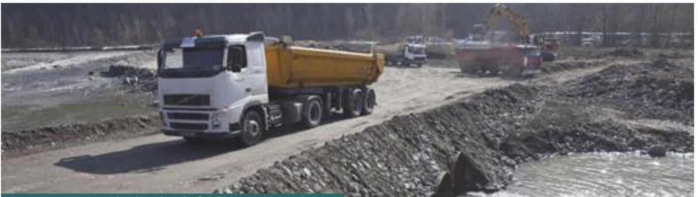
Mars 2013. Passage busé aménagé afin d'évacuer les matériaux curés sur les bancs situés au milieu du lit de la Romanche.
