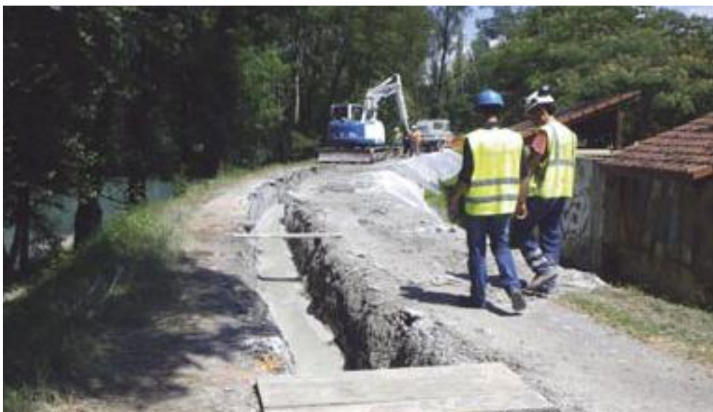
Coulis de ciment-bentonite déversée dans la tranchée creusée sur la piste du domaine universitaire.
