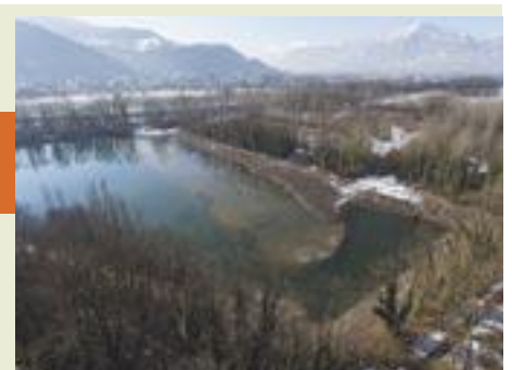
Vue aérienne des terrassements réalisés sur le plan d'eau de la Taillat.
