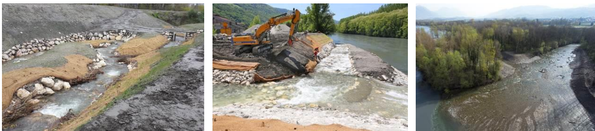
Illustration d'une partie des reconnections piscicoles réalisées sur les ruisseaux du Fay et Renevier au Cheylas, de Lancey à Villard Bonnot et du Bréda à Pontcharra – © Symbhi - SO Dupontrenoux/Photec
