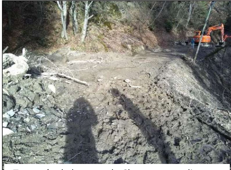
Traversée de la route du Chanay ensevelie sous les matériaux, buse sous voirie obstruée
