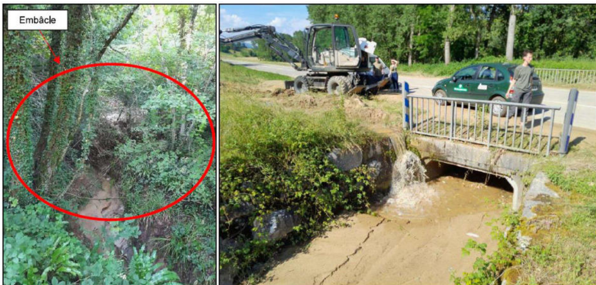
Figure 2 : Embâcle dans l'étréture de la Combe du Nant et pont de la RD le 26/06/2024 (RTM38)
