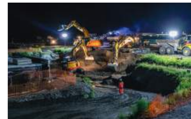
Après l'insertion de la première moitié de la conduite, l'autoroute a été reconstruite, au-dessus du nouvel ouvrage. Afin d'avoir l'impact le plus court possible sur la circulation, les travaux ont été menés en continu durant 5 jours, y compris la nuit.
