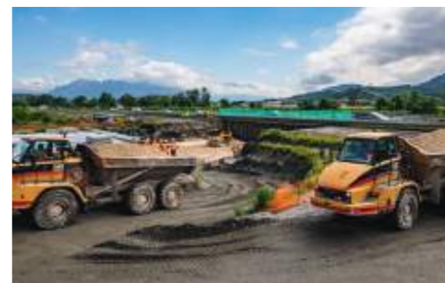
Les camions apportent les graviers sur lesquels vont être roulées les conduites. En contrebas, on aperçoit le haut de la conduite. Au fond, l'autoroute réduite à deux fois une voie.
