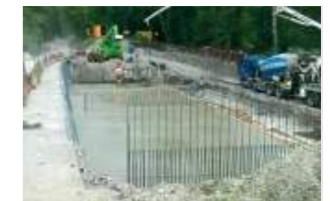
Coiffage d'un clapet.
