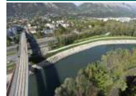
La digue rive droite confortée en amont du pont du tram (La Tronche).
