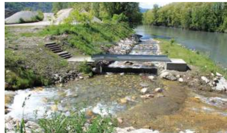
Connexion piscicole du ruisseau de Lancey à l'Isère par une passe à bassins rustique.
