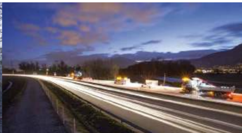
Pose d'une glissière en béton armé le long de la Rocade Sud à Meylan.
