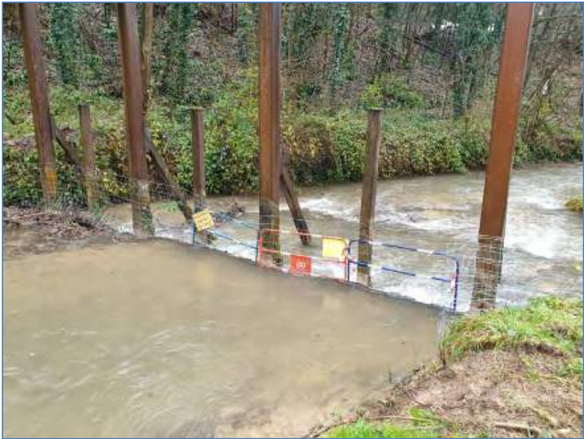
Piège à flottants (grillage) - Piège à embâcles
