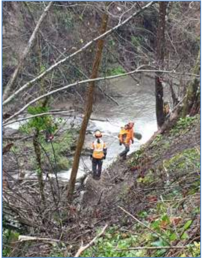
Intervention - Chute d'eau ancienne papèterie
