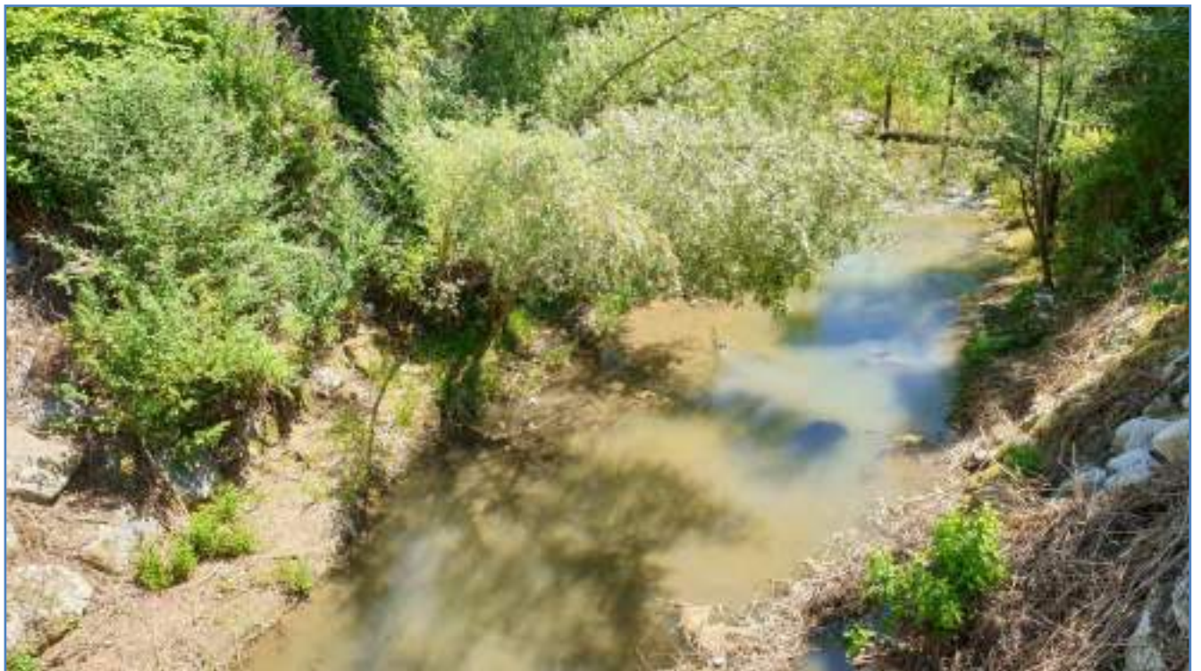
Rétablissement section d'écoulement - Aval du piège à embâcles - Vue depuis le pont de l'hôpital
