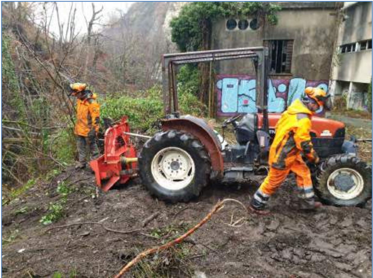
Intervention - Chute d'eau ancienne papèterie
