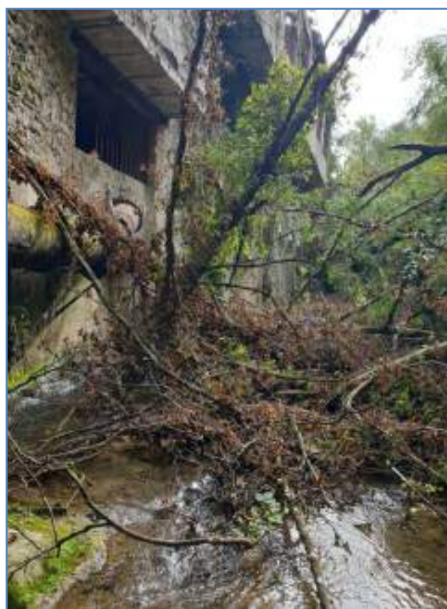
Embâcle - Lit de la Morge – Au droit de l'ancienne papèterie
