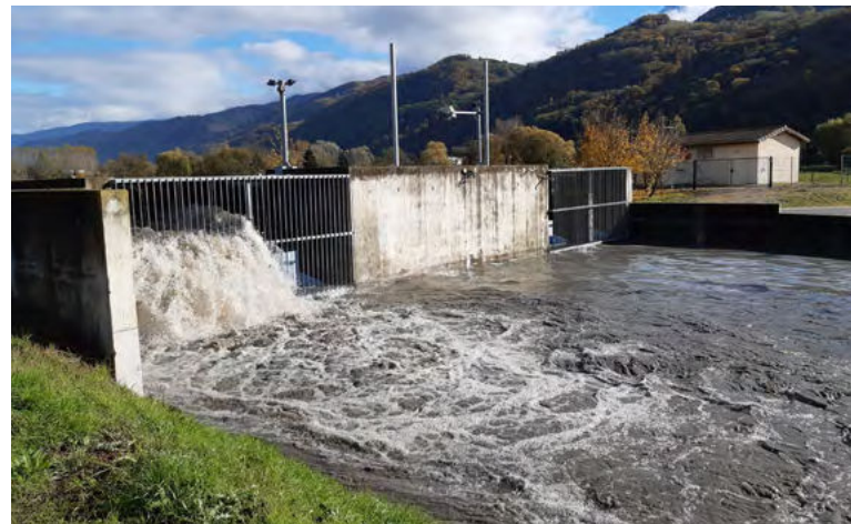
Photo de la station de pompage de Cheminade en action
