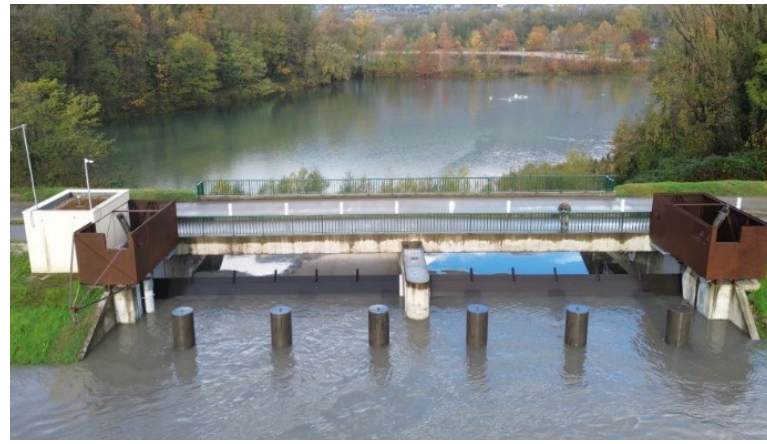
Photo drone des clapets d'alimentation situés sur la commune de Montbonnot-Saint-Martin
